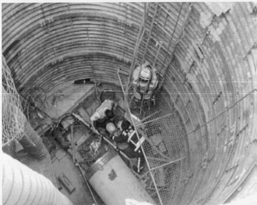
鄭姓工人額頭撕裂傷、背部挫傷，經送醫急救後無生命危險
